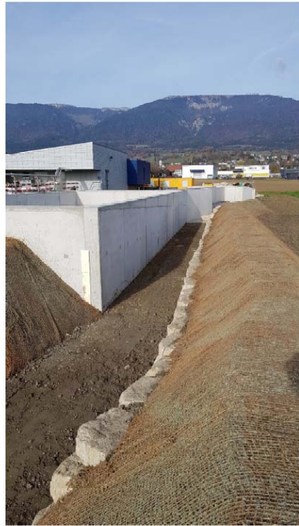
Ablaufkanal in Retention
