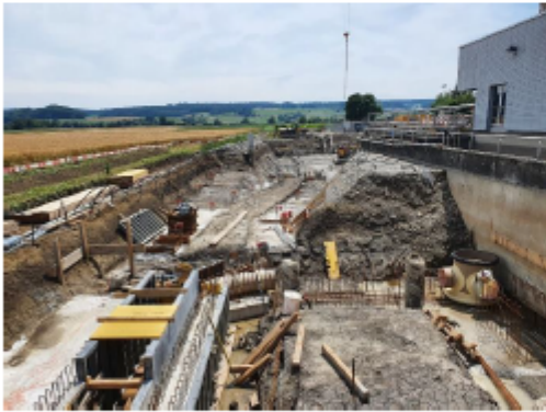
Foto 2: Blickrichtung Süd (Mischabwasserleitung DN 500)
