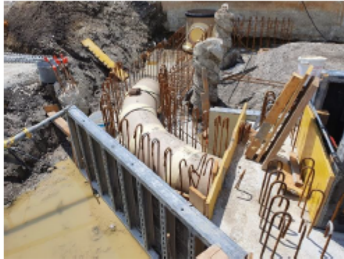
Foto 1: Krümmer DN 500 und KS A1
